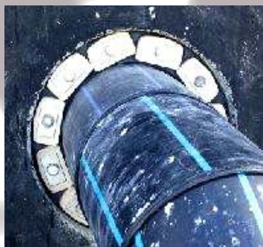
Tlakové potrubí DN 300
